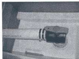
Vanne Évacuation à la mer - Sous le lit - Cabine arrière
