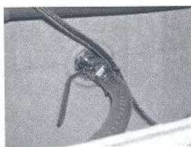
Prise d'eau de mer - Sous Lavabo
